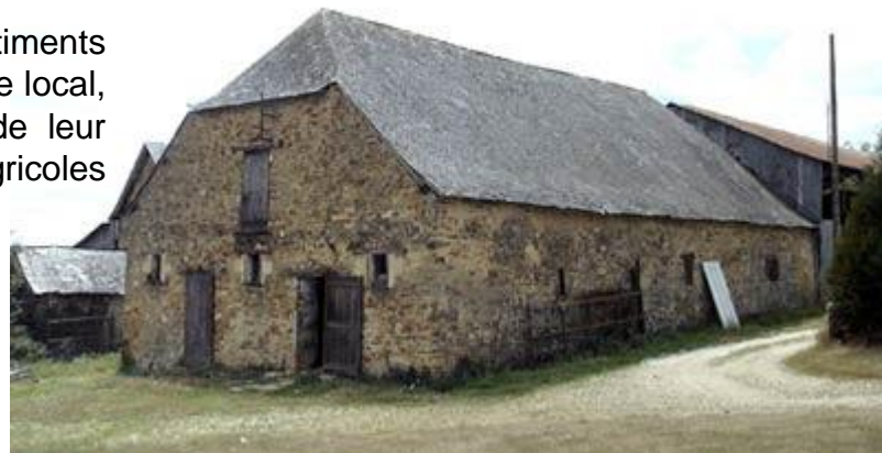
La grange de la Grande-Fellière à Grez-Neuville avec sa toiture en demi-croupe (18 ème siècle).
